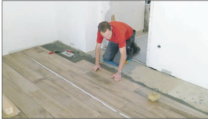
▲ Längliche Fliesen in Holzoptik liegen voll im Trend, die Voraussetzung für die Verlegung ist ein ebener, fester Untergrund, etwa aus Trockenestrich-Elementen. Foto: fermacell/txn
